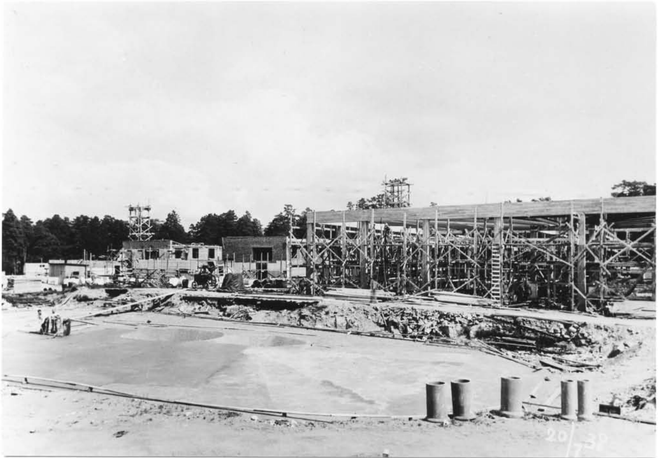
Skogskrematoriet med dess kapell under uppförande. Monumenthallen t.h. och i förgrunden den blivande näckrosdammen. Foto från 20.7 1938.
